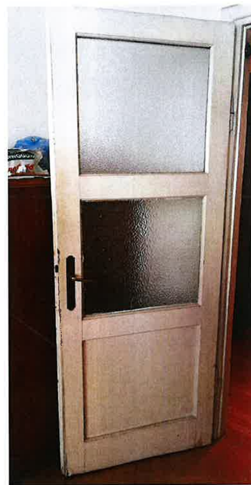
stolarka drzwiowa w jednym z mieszkań
